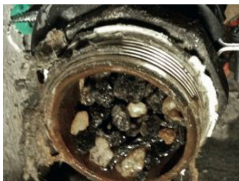
Hovedledning inn til stort bygg.
