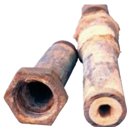
Vannrør før og etter rens
