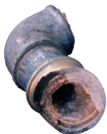
Vannrør med humus, oksider og kalk
